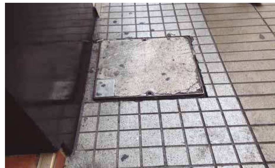
REGISTROS DETERIORADOS Y MAL NIVELADOS, SANTIAGO
