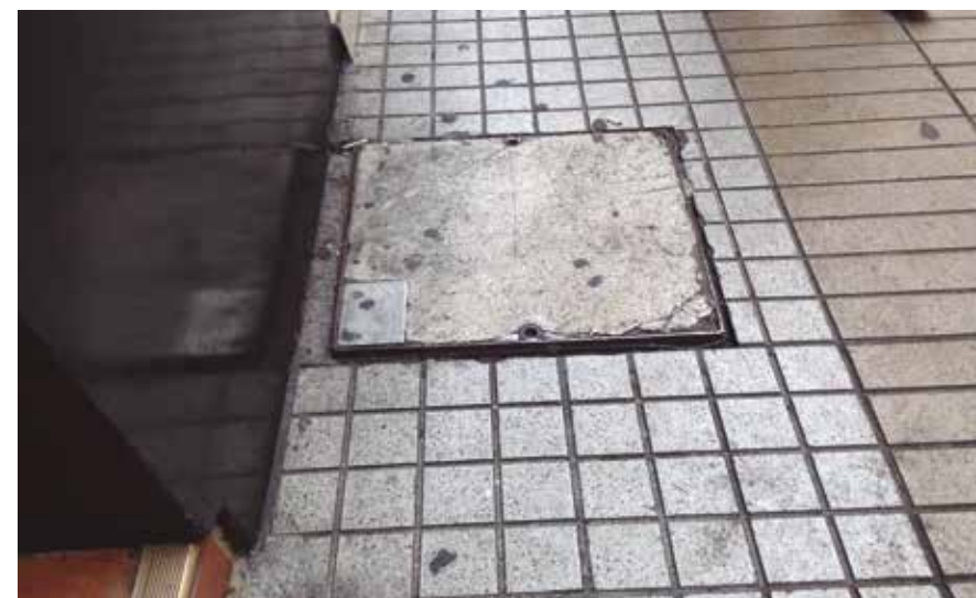
REGISTROS DETERIORADOS Y MAL NIVELADOS, SANTIAGO
