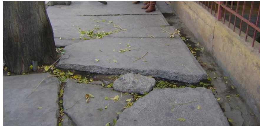
Deterioro de pavimento producido por crecimiento de raíces, Rengo y Santiago
