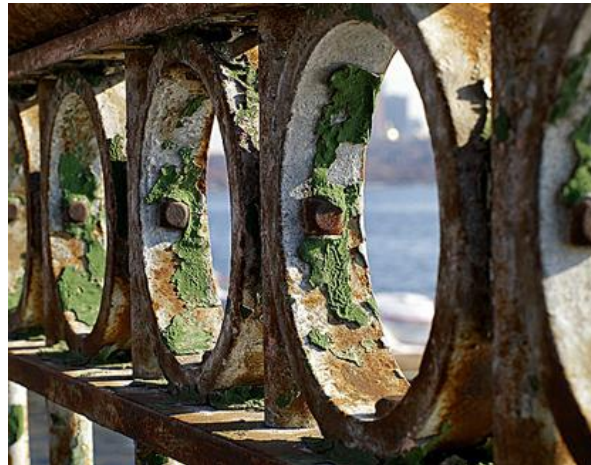
Corrosión cerramiento metálico Fuente: www.laciudadviva.org
