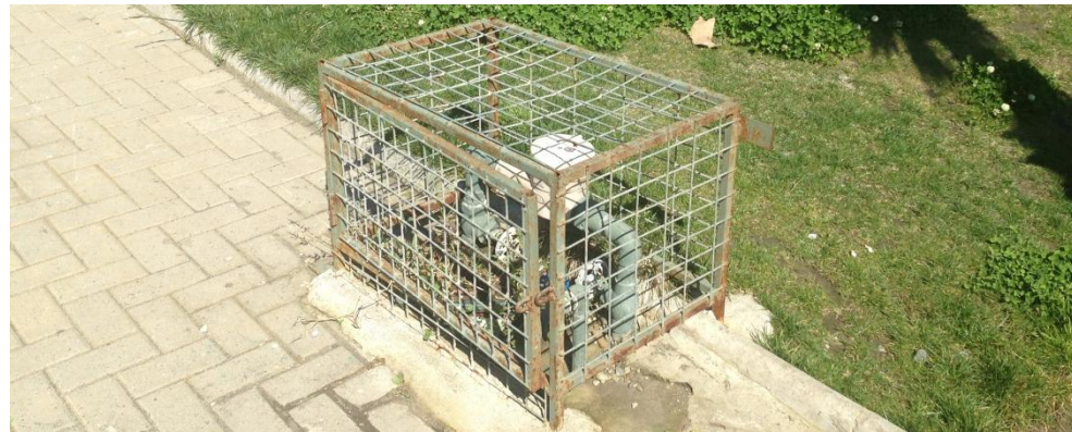
Tomas de agua para riego manual con manguera, Rengo y Constitución
