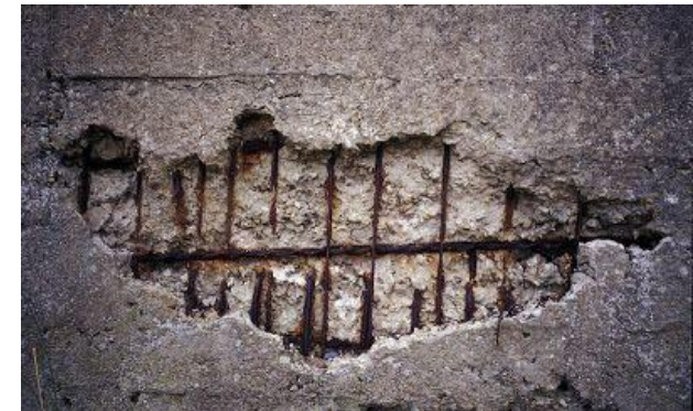
Erosión de muro hormigón
