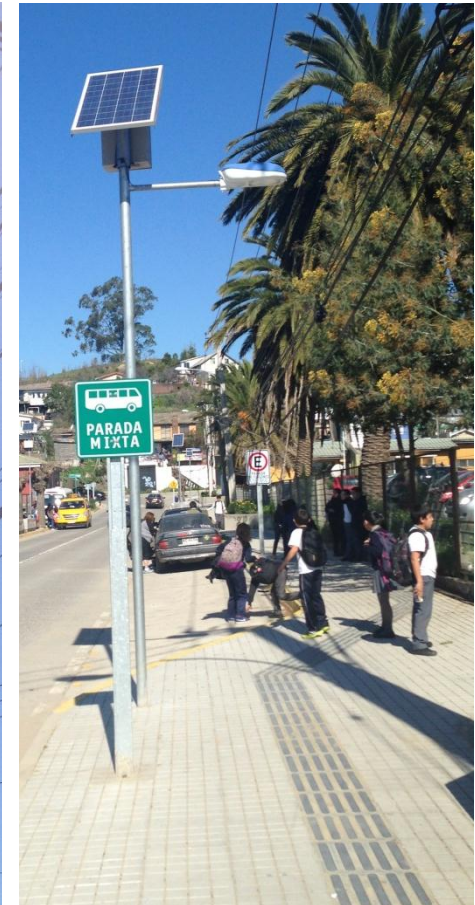
Luminarias fotovoltaicas, Constitución Fuente: CDT
