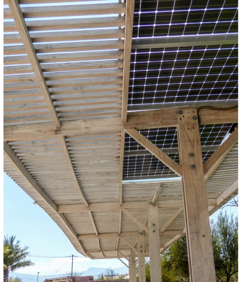
Paneles Fotovoltaicos en Parque Quilapilún Fuente: Carolina López
