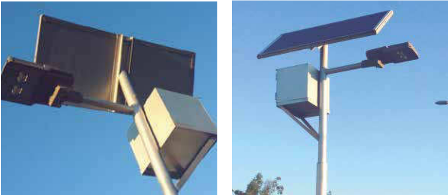
LUMINARIA SOLAR EN PARADEROS DE BUSES, COLINA
