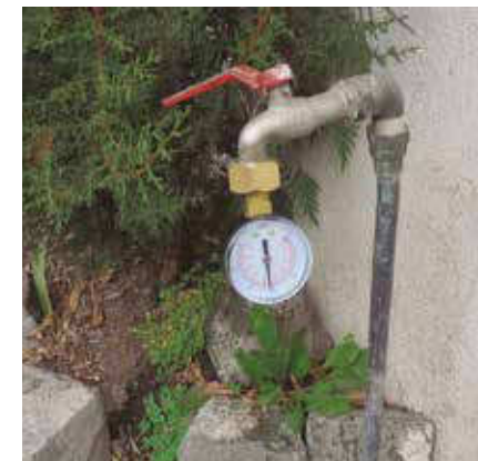
MEDICIÓN DE PRESIÓN CON MANÓMETRO
